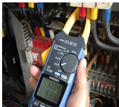
วัดค่าพลังงานไฟฟ้า
