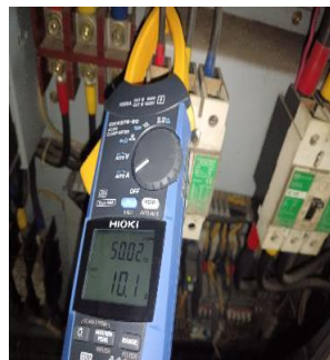
วัดค่าพลังงานไฟฟ้า
